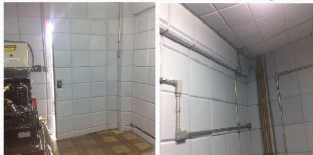
Revestimento Acústico em Sala de Máquinas
